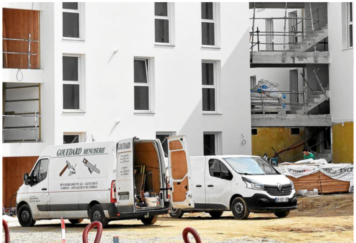
À chaque entreprise sa cage d'escalier. Ce jeudi neuf compagnons travaillent sur le chantier de la future gendarmerie de Saint-Avé, en suivant des règles strictes. La livraison du chantier, annoncée pour la fin juillet est maintenant espérée pour fin septembre.
